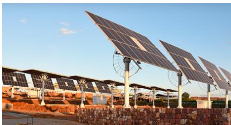
Figura 2: Painéis de Energia Solar
