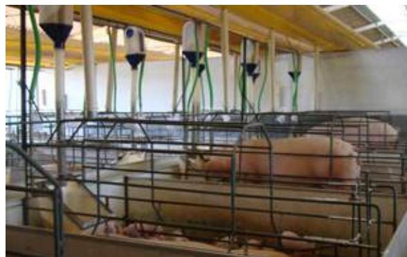
FIGURA 4: sala de maternidade com utilização de ducto fan para melhora de sensação térmica das fêmeas
