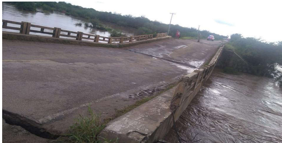
Imagem III - Ponte prestes a cair, na cidade de Bodocó-PE.
