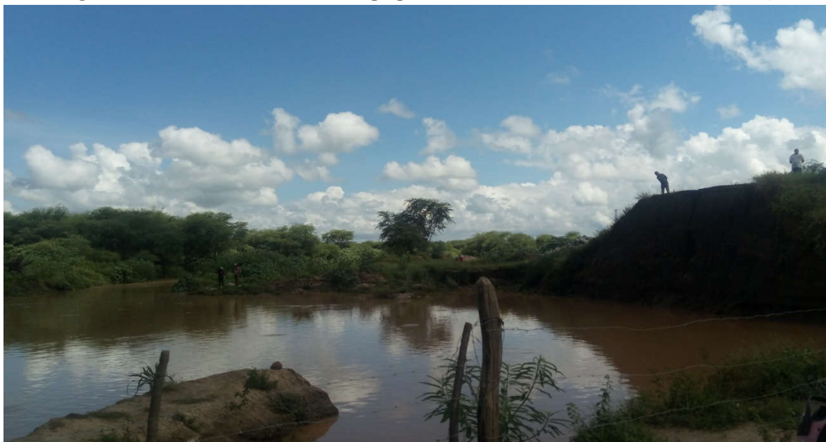
Imagem VII - Ponte sobre o riacho do pequi em 2019 ainda sem indícios de reconstrução.
